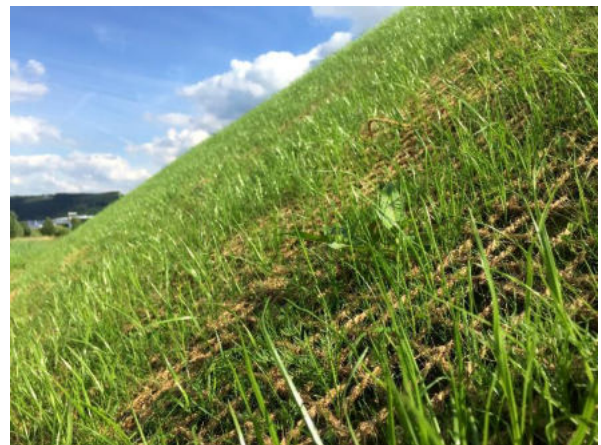
Abbildung 5-1: Kokosmatte im Erosionsschutz
