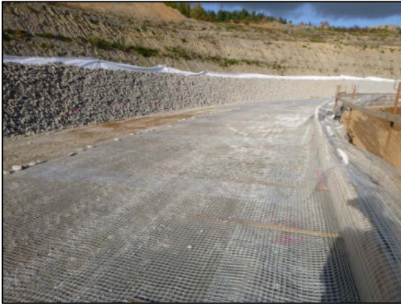
Abbildung 2-3: Verlegte Geogitter mit über dem Schalungselement nach vorn hängender Rückverankerung und rückseitiger Drainage aus grobem Schotter
