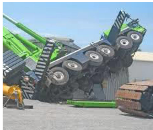
Abbildung 1: Beispiel für umgestürzte Baumaschinen
