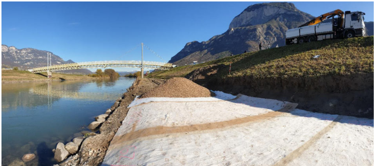
Abbildung 3-1: Einbau einer geosynthetischen Tondichtungsbahn (Bentonitmatte) mit biologisch abbaubaren Träger- und Decklagen (Vliesstoff- bzw. Gewebekomponenten) am Flussufer der Etsch in Südtirol
