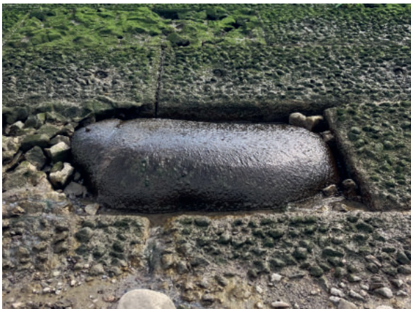
Abbildung 2: Lokaler Deckwerksschaden an der Tideweser im Bereich Neuenkirchen mit aufgebrochener Schutzschicht. Im geotextilen Filter wurden Verockerungsprodukte nachgewiesen. Aufgenommen im Jahr 2022.
