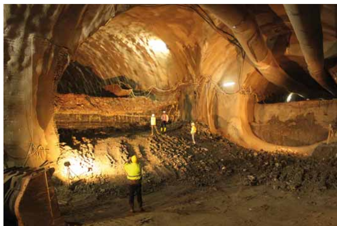
Bild 14. Blick in die Abluftkaverne.
