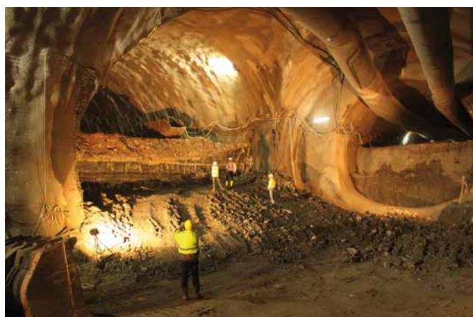
Bild 14. Blick in die Abluftkaverne.
