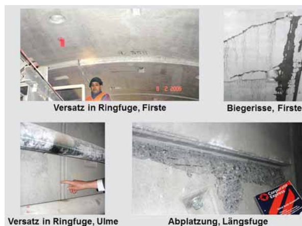
Bild 4. Schäden infolge fehlender Horizontalbelastung und Bettung.
