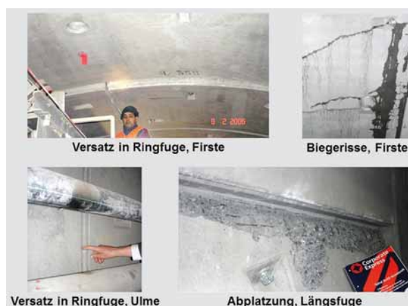
Bild 4. Schäden infolge fehlender Horizontalbelastung und Bettung.
