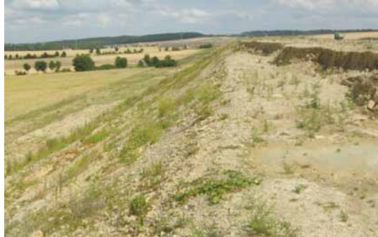
Bild 3. Schadensbild mit Blick von der Böschungsschulter in Richtung Ost.
