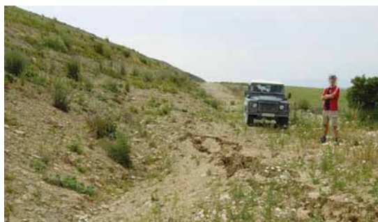
Bild 4. Schadensbild am Böschungsfuß mit Blickrichtung West.
